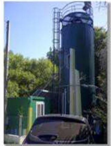
Depuración en Mos (EDAR)
